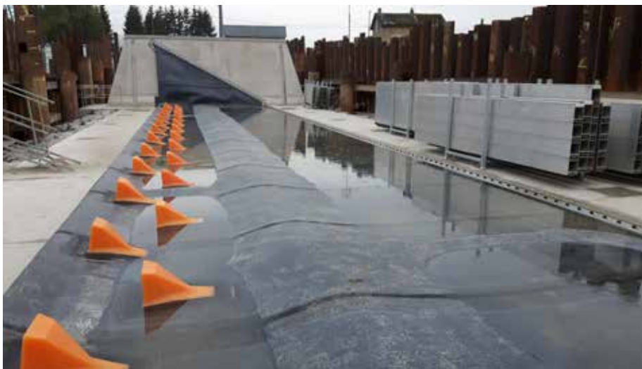
Bouchure installée en position effacée. Elle sera dans cette position lors des crues.
