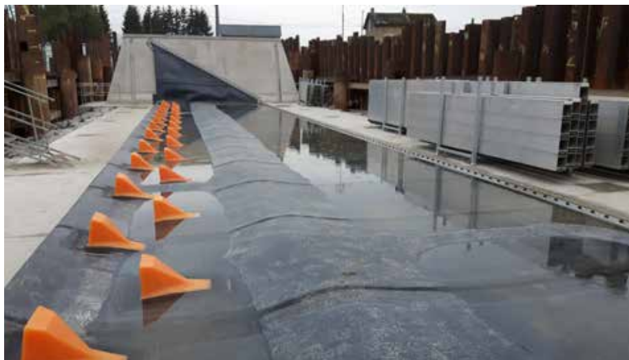
Bouchure installée en position effacée. Elle sera dans cette position lors des crues.
