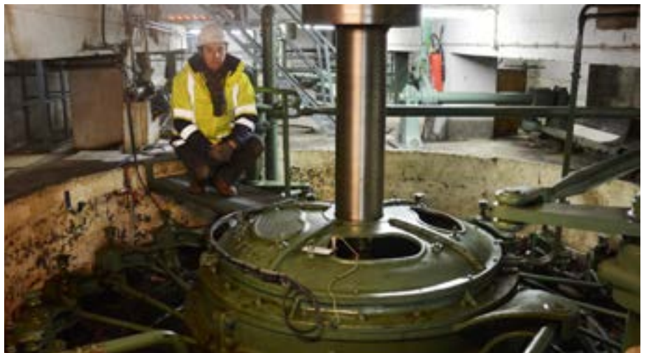
Turbine datant des années 1930 à la microcentrale de Revin (08)
