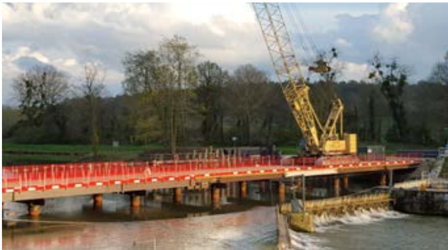
Barrage de Fontenoy (02) : estacade permettant de réaliser les travaux directement sur la rivière
